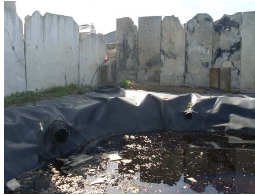
Fig. 10. Vue des deux canalisations d'arrivée dans la lagune L1
